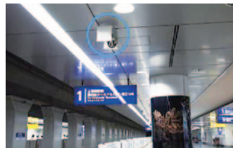
ホームに設置されたアンテナ
